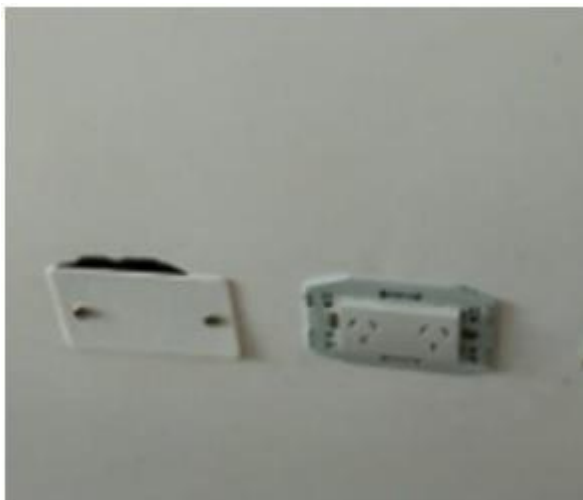
Tomacorrientes doble IRAM 2071 (cerrado, sin tapa)
