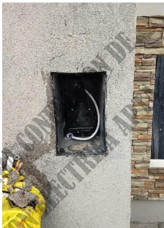
Caja para medidor monofásico
