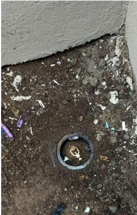
Caja de inspección de jabalina de PAT (abierto)
