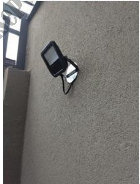
Boca de iluminación en pared (exterior) con luminaria instalada
